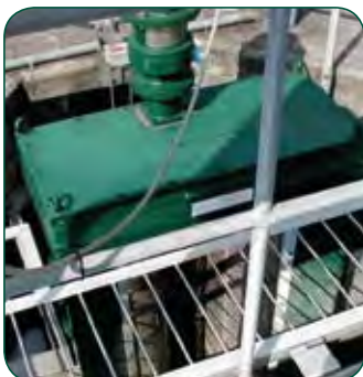
Модель CDD на сооружениях предварительной очистки сточных вод
