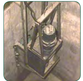
Channel Monster, установленный в насосной станции с направляющей рамой.
