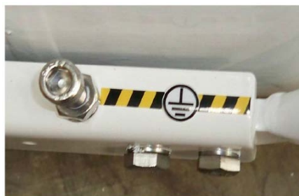
Рисунок 3 – Контактная площадка заземления на насосе
